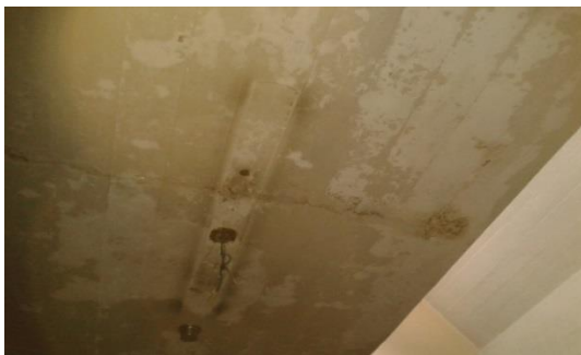
Una de las vías de agua en una parte del techo
